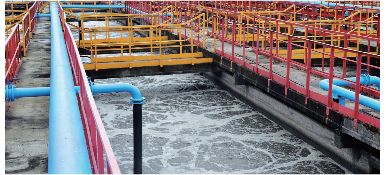
工业废水处理
